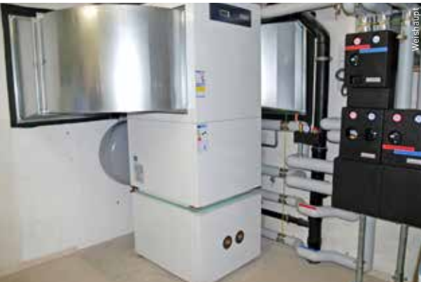
Die neu installierte Luft-Wasser-Wärmepumpe mit hervorragender Energieausbeute und einer Energieeffizienzklasse von A+.
