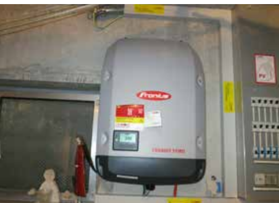
Wechselrichter für die Photovoltaik Anlage. Dieser wandelt Gleichstrom in Wechselstrom um.
