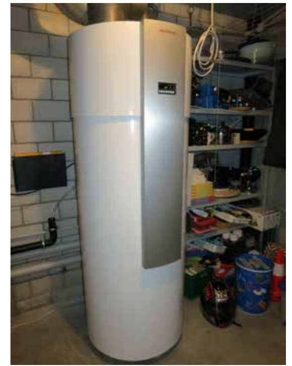
Die Trinkwasserwärmepumpe weist einen COP von 3,6 auf.
