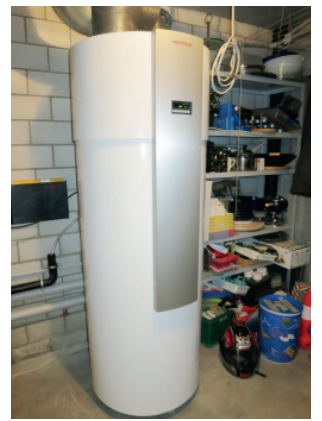
Die Trinkwasserwärmepumpe weist einen COP von 3,6 auf.
