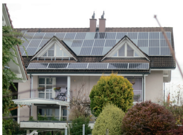
Die Photovoltaik-Anlage des Zweifamilienhauses in Luzern: Damit die Trinkwasserwärmepumpe mit elektrischer Solarenergie betrieben werden kann, genügen in der Regel 3 bis 4 Panel.
