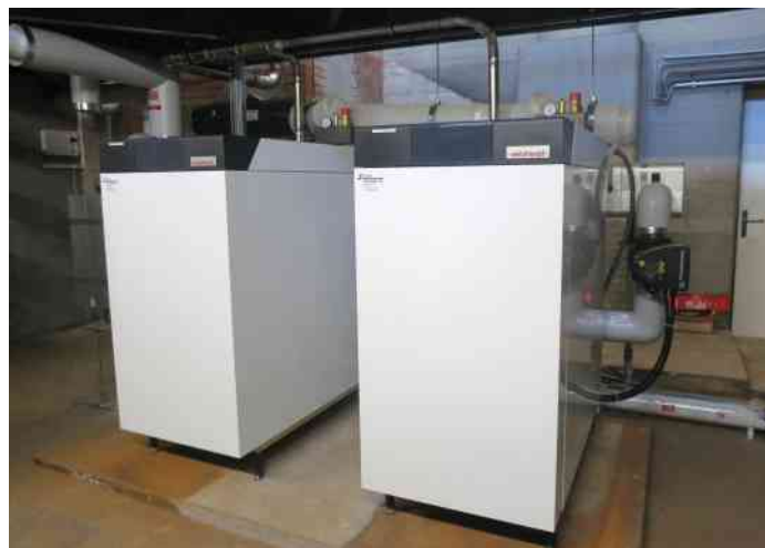
Gasbrennwert-Kessel in Kaskade mit total 580 kW Leistung von Weishaupt mit hoher Effizienz, Funktionalität und kompakter Bauweise.
