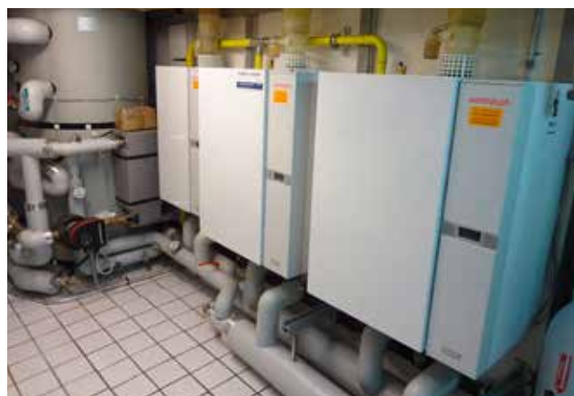
Links der Weishaupt WTC-32A-Gas-Brennwert-Wandkessel, dann die beiden WTC 60A-Wandkessel. Hinten der 500-l-Boiler in der Dachzentrale des Hotels Ambassador.
