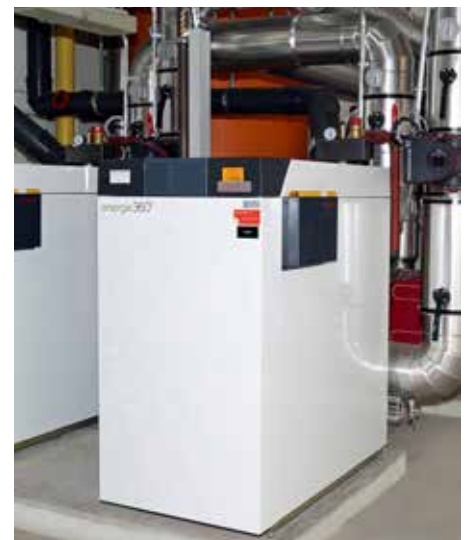
Die beiden Weisshaupt Thermo Condens WTC GB 250 in der Hohenegg.
