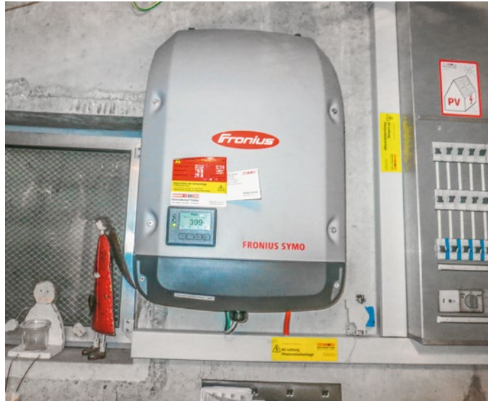
Wechselrichter für die Photovoltaikanlage (wandelt Gleichstrom in Wechselstrom um).
