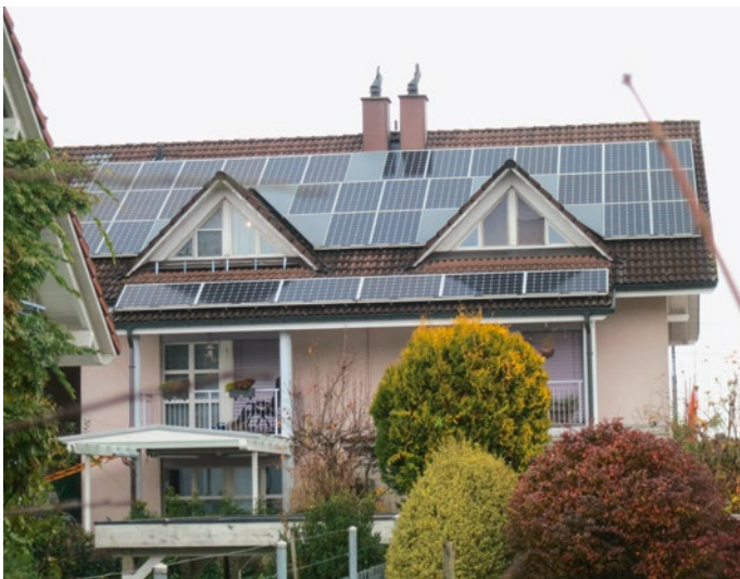
Die Photovoltaik-Anlage des Zweifamilienhauses in Luzern (für die Betreibung der Trinkwasserwärmepumpe mit elektrischer Solarenergie genügen in der Regel 3-4 Panel).
