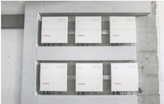
Sechs Gruppen der Wärmeverteilung sorgen je mit einem Erweiterungsmodul für ein optimal eingestelltes Raumklima.
