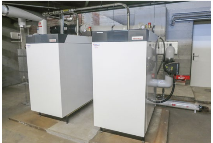
Der neue, kompakte Gasbrennwertkessel in Zweierkaskade mit total 580 kW Leistung von Weishaupt mit hoher Effizienz und Funktionalität.
