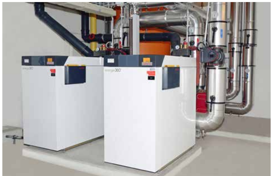
Die beiden Weishaupt Thermo Condens WTC GB 250 in der Hohenegg.
