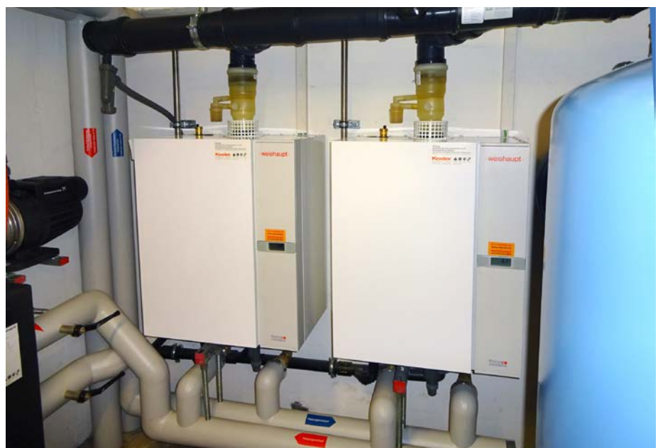
Ein Weishaupt WTC 60A und ein WTC 45A Gas-Brennwert-Wandkessel in der Dachzentrale des Hotel Opera.
