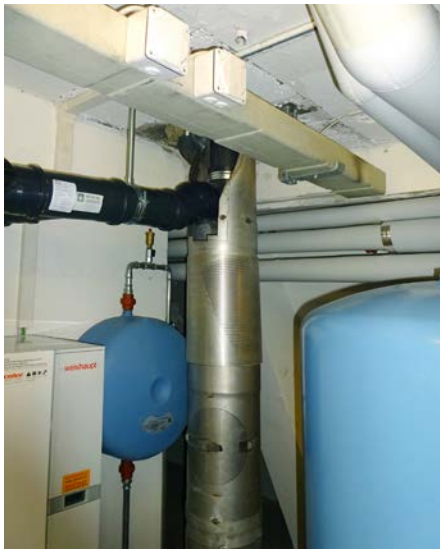
Kunststoff-Abgasleitung im alten Chromstahl-Kamin.
