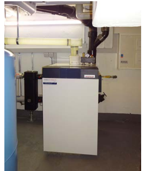
Der Weishaupt-Gas-Standkessel WTC GB90 in der Heizzentrale des Opera, Dufourstr. 3, links die hydraulische Weiche.
