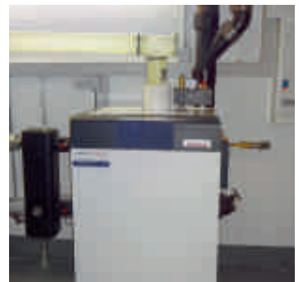
Fig. 7 Der Weishaupt-Gas-Standkessel WTC-GB90 in der Heizzentrale des Opera, links die hydraulische Weiche Chaudière au sol à gaz Weishaupt WTC-GB90 dans la centrale de chauffe de l'Opera, à g., séparateur hydraulique
