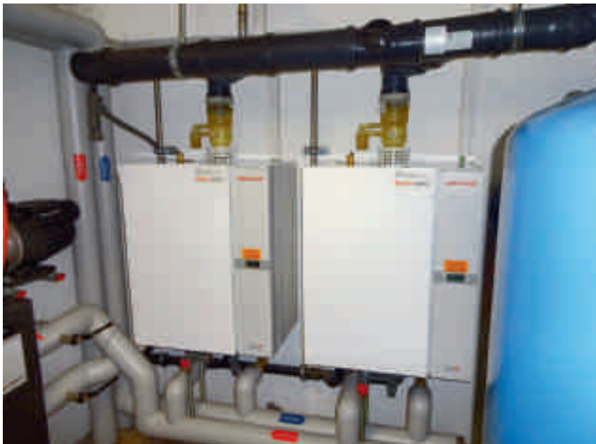
Fig. 5 Ein Weishaupt WTC-60A- und ein WTC-45A-Gas-Brennwert-Wandkessel in der Dachzentrale des Hotels Opera Une chaudière murale à gaz Weishaupt WTC-60A et WTC-45A à pouvoir calorifique supérieur dans la centrale sous toit de l'hôtel Opera
