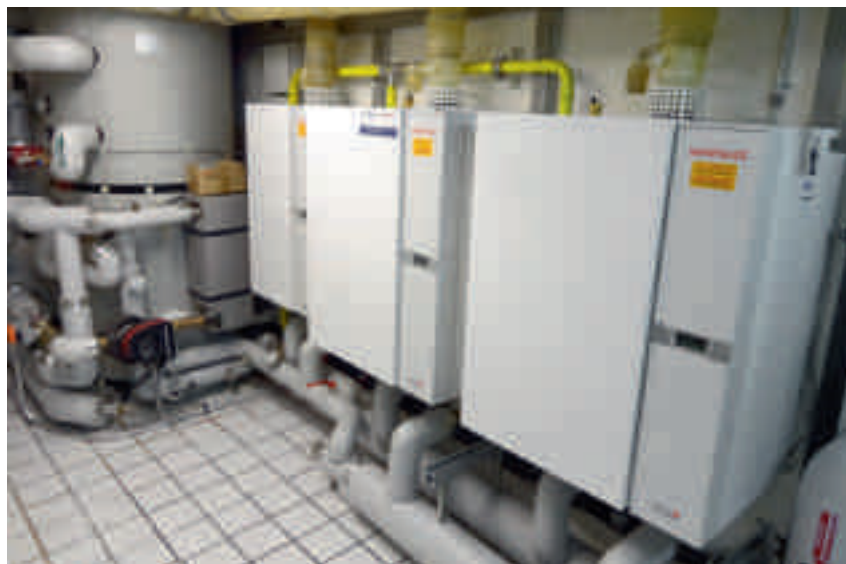
Fig. 2 Links der Weishaupt WTC-32A-Gas-Brennwert-Wandkessel, dann die beiden WTC-60A-Wandkessel, hinten der 500-Liter-Boiler
