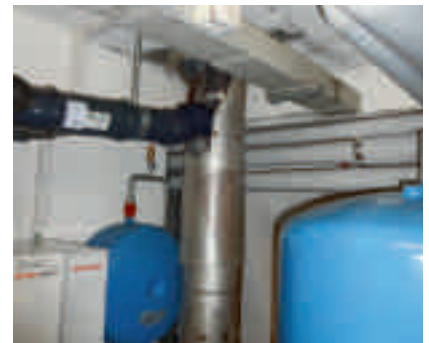
Fig. 6 Kunststoff-Abgasleitung im alten Chromstahl-Kamin Conduite d'échappement en plastique dans l'ancienne cheminée en acier chromé
