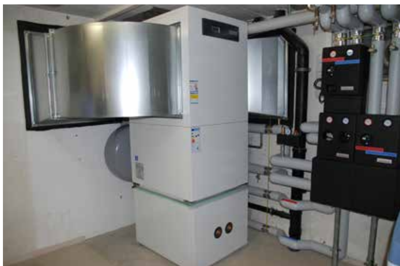
Die neu installierte Luft-Wasser Wärmepumpe mit hervorragender Energieausbeute und einer Energieeffizienzklasse von A+.
