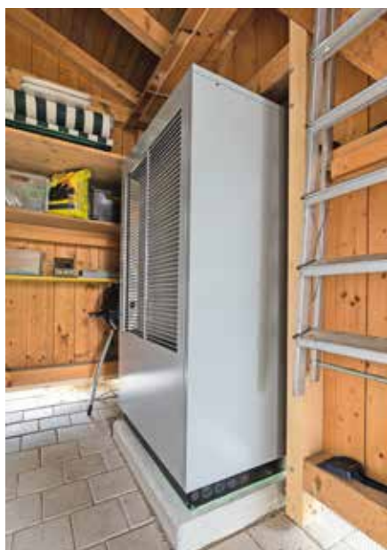
Die Wärmepumpe im Innern des Schopfs.
