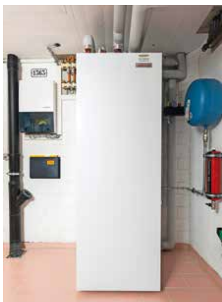
Der WKS-Kombi-Speicher wurde in der Waschküche platziert.
