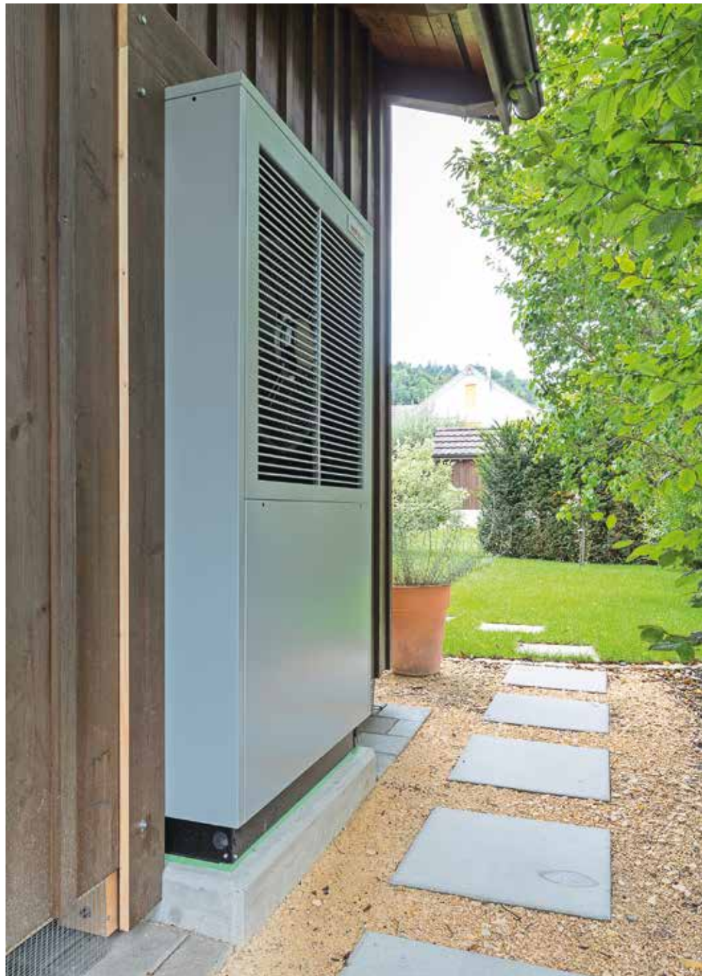
Aufgrund der vorhandenen Platzverhältnisse hatte der Hauseigentümer eine spezielle Idee: Die Wärmepumpe sollte zur Hälfte im Schopf und zur Hälfte im Freien platziert werden.
