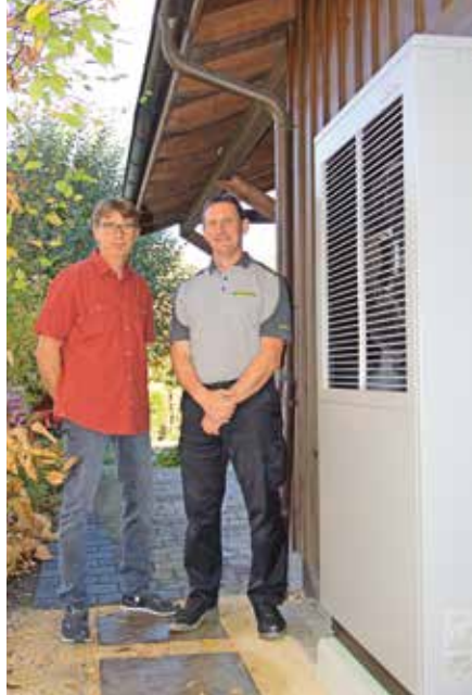
Ein gut eingespieltes Team: Bauherr Friedrich Beier (links) und Installateur Daniel Kägi (rechts).
