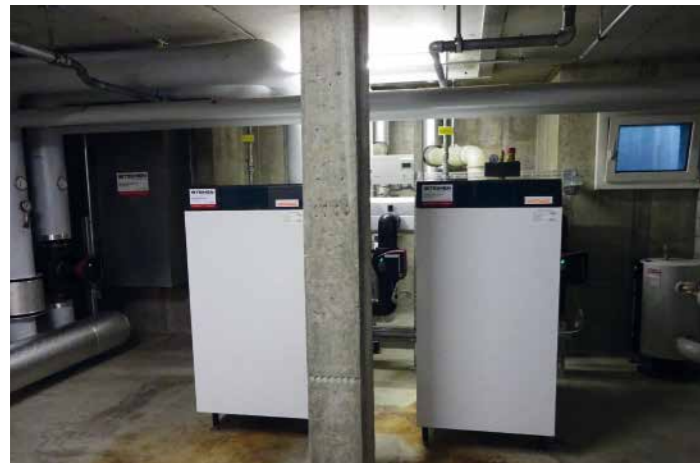
Die Gas-Brennwertkessel in der Bärenweid-Zentrale.
