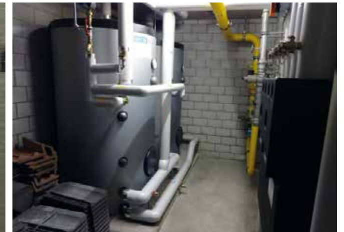
Die beiden 600-Liter-Boiler und rechts die Modulverteiler-Elemente in einer der Unterstationen.
