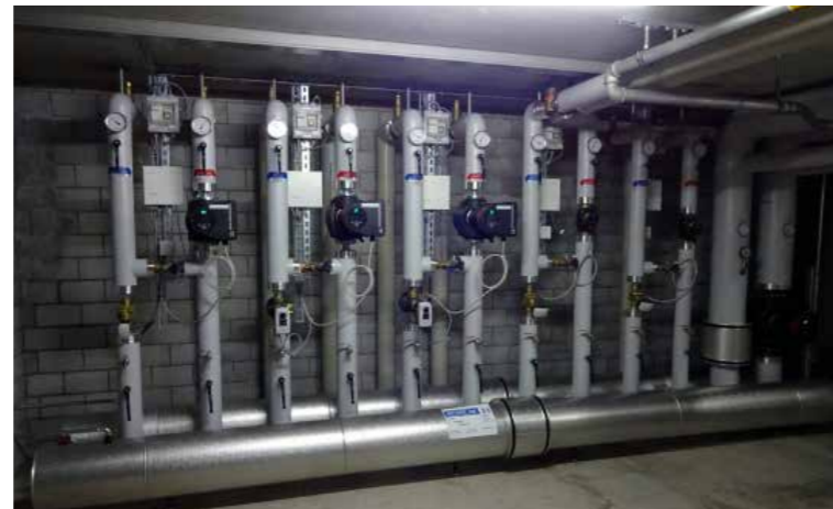
Die Verteilanlage in der Heizzentrale.
