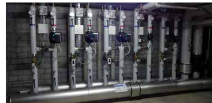
Die Verteilanlage in der Heizzentrale.
