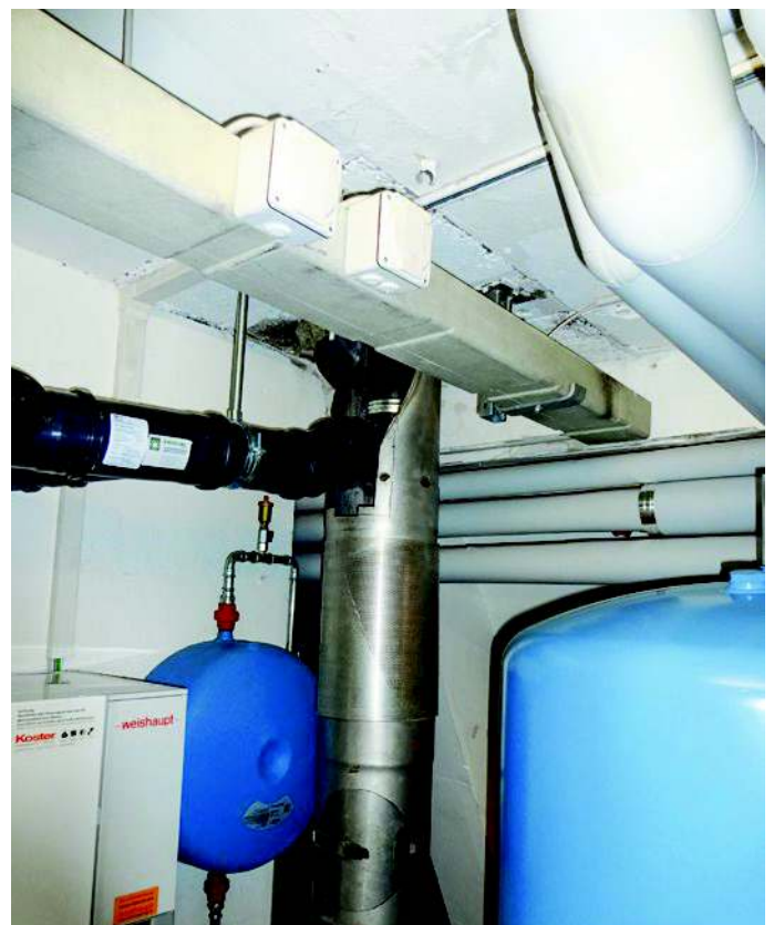
Kunststoff-Abgasleitung im alten Chromstahl-Kamin.
