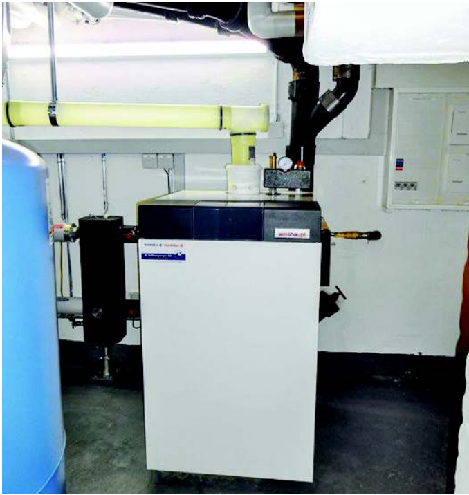
Der Weishaupt-Gas-Standkessel WTC-GB90 in der Heizzentrale des Opera, Dufourstrasse 3, links die hydraulische Weiche.
