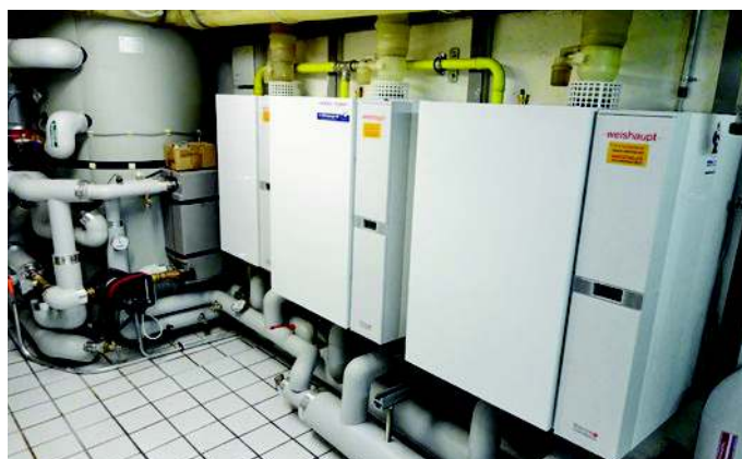
Links der Weishaupt WTC-32A-Gas-Brennwert-Wandkessel, dann die beiden WTC-60A-Wandkessel. Hinten der 500-l-Boiler.
