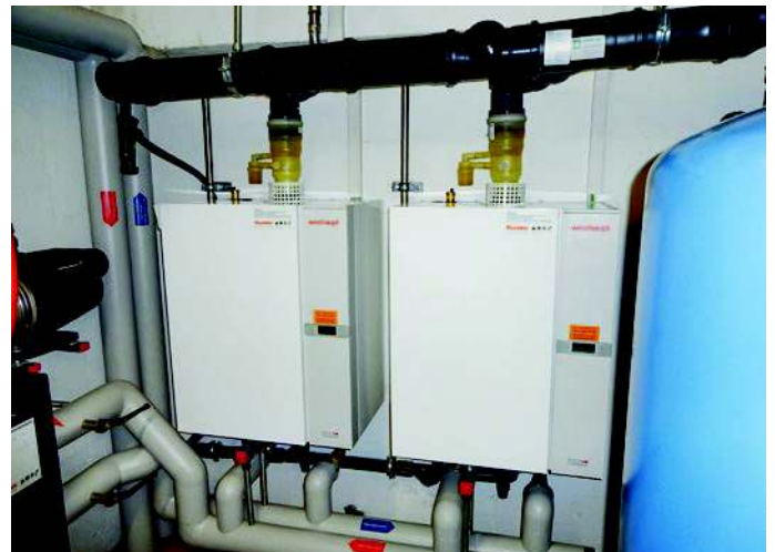
Ein Weishaupt WTC-60A- und ein WTC-45A-Gas-Brennwert-Wandkessel in der Dachzentrale des Hotels Opera.
