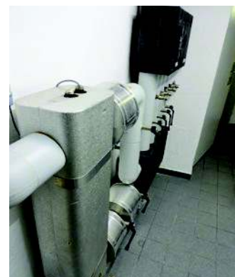
Um die Ecke die hydraulische Weiche mit einem Teil der Weishaupt-Verteiler-Elemente.
