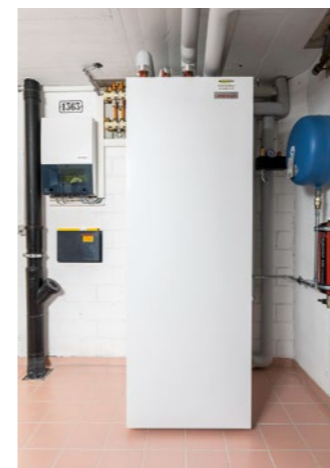
Der WKS-Kombi-Speicher platziert in der Waschküche.
