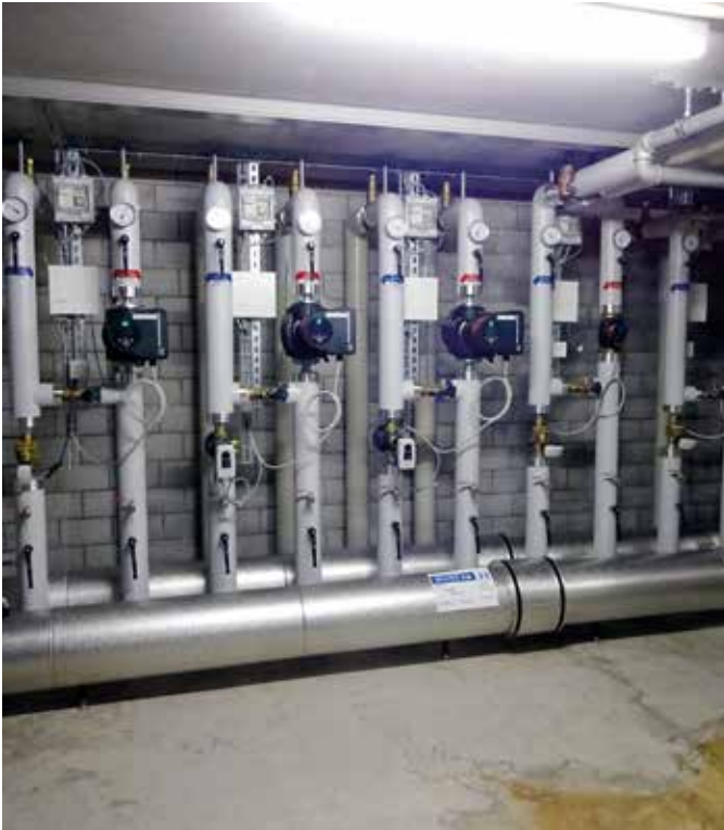
Die Verteilanlage in der Heizzentrale
