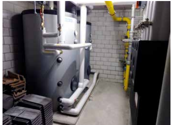
Die beiden 600-Liter-Boiler und rechts die Modulverteiler-Elemente von Weishaupt in einer der Unterstationen
