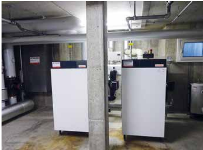
Die beiden Gas-Brennwertkessel Thermo Condens WTC-GB 300 von Weishaupt in der Bärenweid-Zentrale
