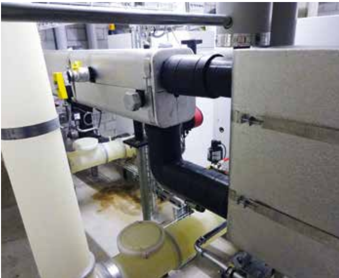
Rückansicht der Kessel mit Weishaupt-Kaskade
