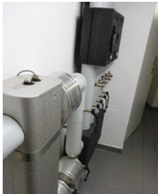
Um die Ecke platziert: die hydraulische Weiche mit einem Teil der Weishaupt Verteiler-Elemente.
