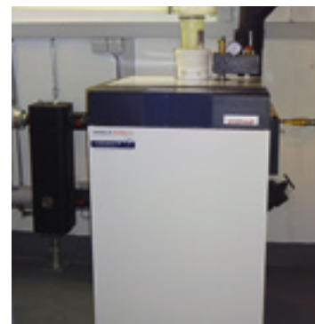
Der Weishaupt Gas-Standkessel WTC GB90 in der Heizzentrale des Hotels Opera an der Dufourstrasse 3 in Zürich; links die hydraulische Weiche.
