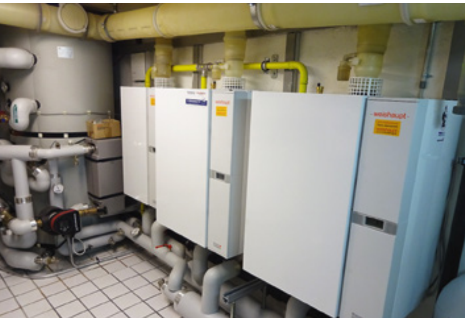
Links im Bild der Weishaupt Gas-Brennwert-Wandkessel WTC-32A, dann folgen die beiden Weishaupt WTC 60A-Wandkessel, hinten der 500-Liter-Boiler.
