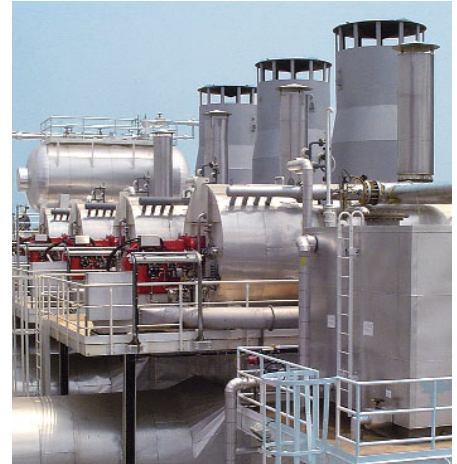
Fire RGL70 brændere på termiske oliekedler sørger for, at råoliens kan pumpes op
